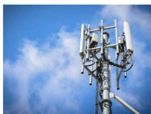
5G communication base station 5G通讯基站 671应用
